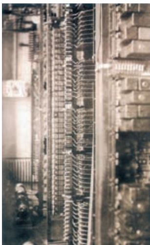
Декадалы-адымлы система станциясы.
