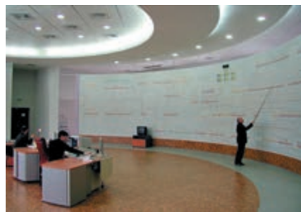
Центр диспетчерский щит энергосистемы РТ.
